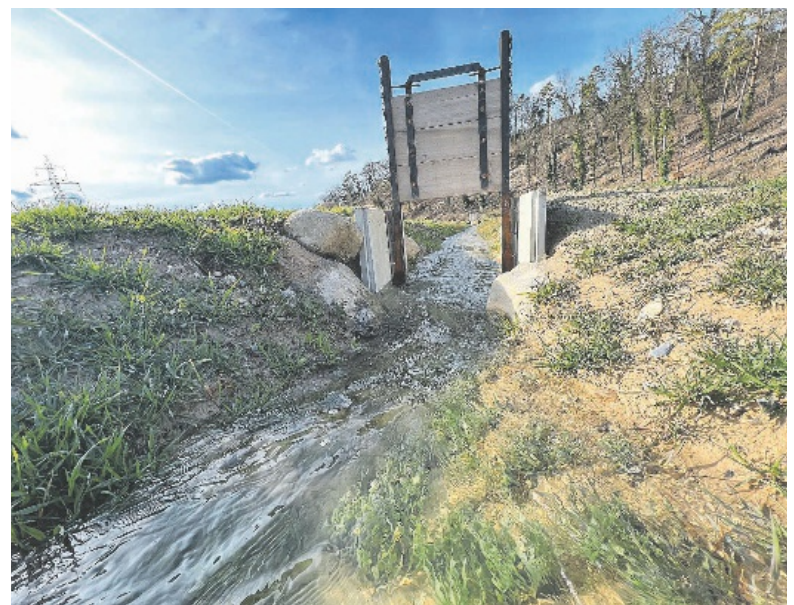
1280 m Wasserkanäle wurden wieder gebaut. Hinzu kommen kleinere Seitengräben für die Verteilung des Wassers auf die Wiesen (ca. 400 m) sowie 15 Schieber für das Verteilen und Stauen des Wassers im Kanalsystem. Damit wird das Bewässern einer Wiesenfläche von ca. 1,25 Hektaren wieder möglich.
