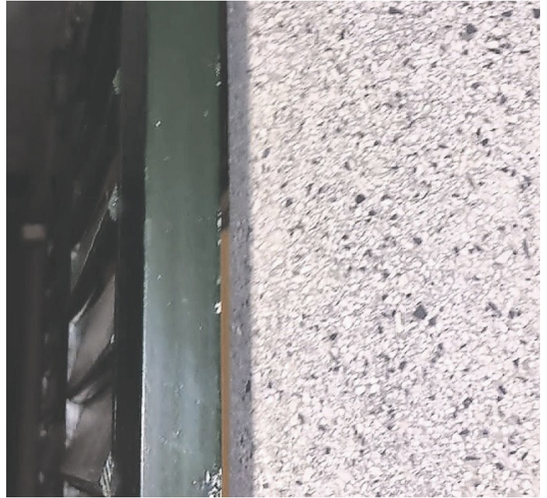
Der von den Tätern malträtierte Fensterladen an der Rainstrasse.
